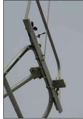
Photo 49 : Exemple d'anémomètre et girouette sur nacelle (Source : The Wind Power)
